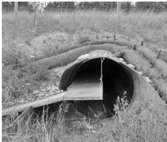
Alcantarilla de drenaje con estante de metal atornillado para facilitar el cruce de animales terrestres
