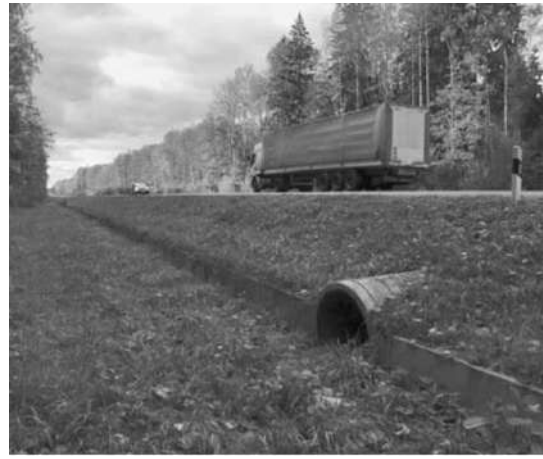
Muro de concreto tradicional y túnel de drenaje para anfibios y mamíferos terrestres pequeños
