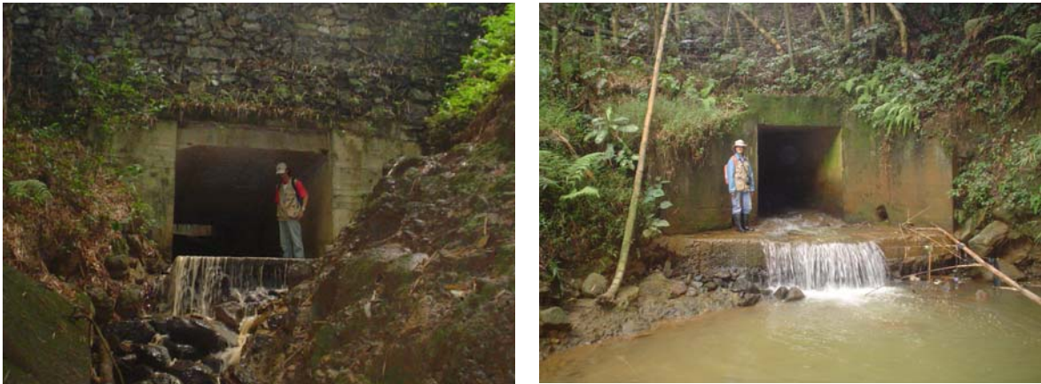
Foto A2.6. Canalizaciones. Quebrada la Presidenta
