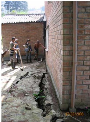
Foto A2.4. Casa fallada por aguas perdidas. Quebrada La Presidenta parte alta
