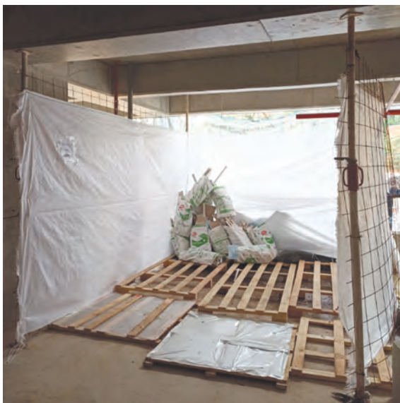
Fotografía 5. Acopio de madera sobre estibas dentro de la misma edificación en construcción.
