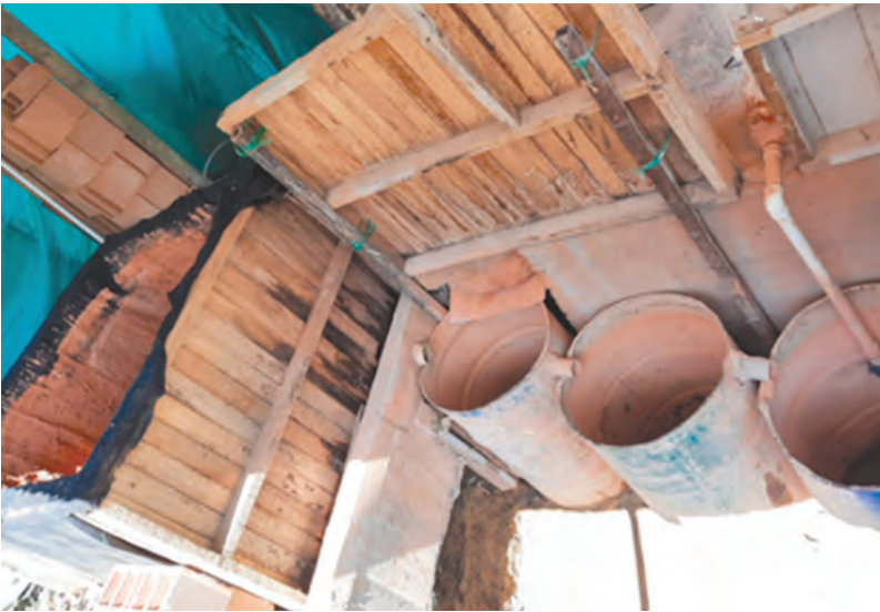
Fotografía 10. Sistema de recirculación para el aprovechamiento de agua en la actividad de corte de mampostería.
