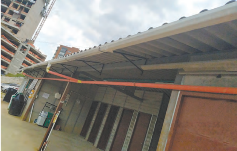
Fotografía 8. Sistema de recolección de agua lluvia en cubiertas.
