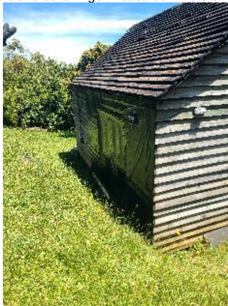
Foto del lote alto de la virgen - casa del vivero en mal estado
